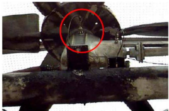
下から大規模セルファンを見ており、ギヤボックス側に 799LF 低周波加速度センサーが取り付けられています。
